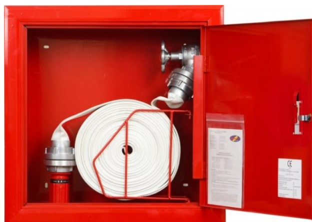
Hydrant wewnętrzny 52 z węzłem płasko składanym w koszu węzowy.
