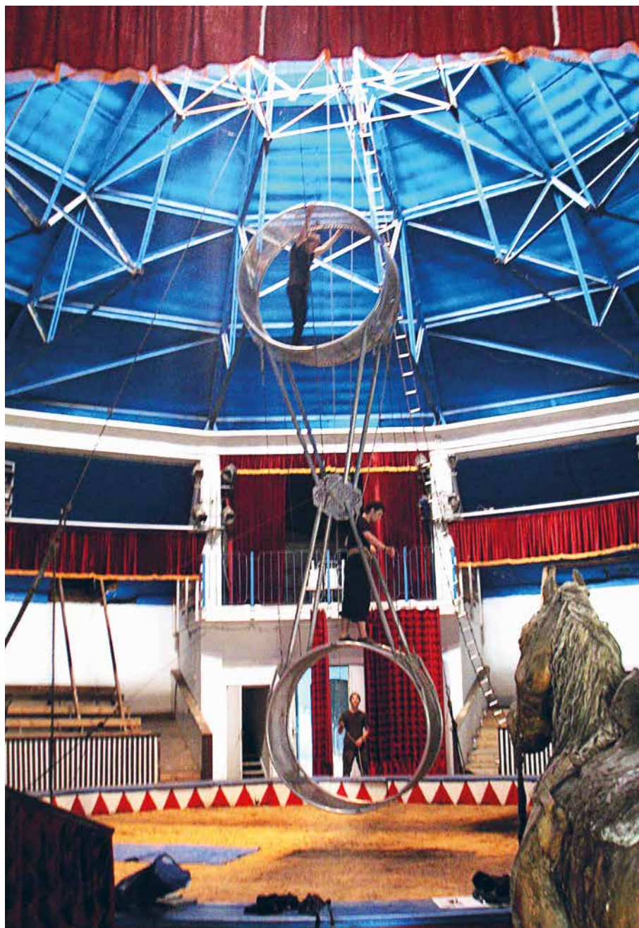
77. Wnętrze Wielkiej Areny, budynku Państwowej Szkoły Sztuki Cyrkowej w Julinku, stan przed remontem.
