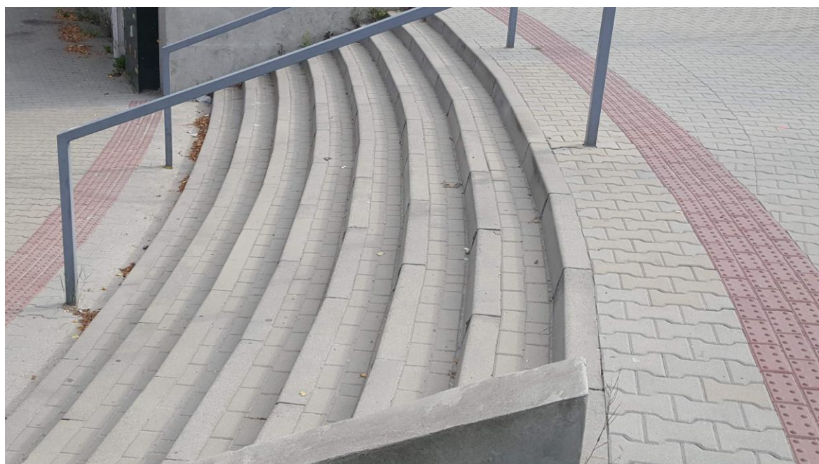
Zdjęcie nr 2 – Guzki przy schodach- oznakowanie schodów dla osób nie(do)widzących
