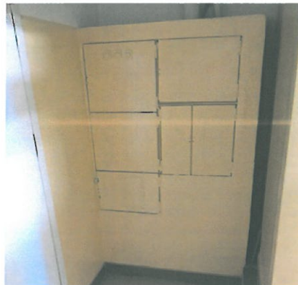
Tablice na KL.1 na kondygnacji -1
