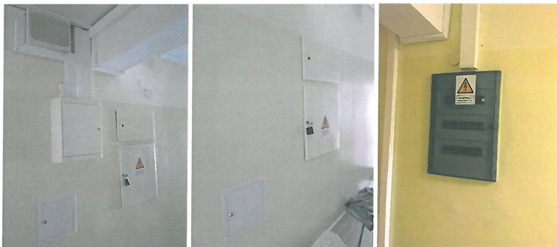
Tablice elektryczne na korytarzach
