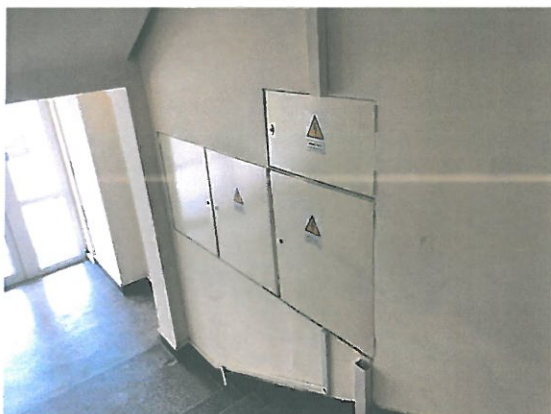
Tablice na KL.1 na kondygnacji -1
