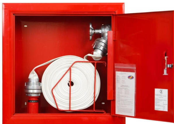
Hydrant wewnętrzny 52 z węzem płasko składanym w koszu węzowy.
