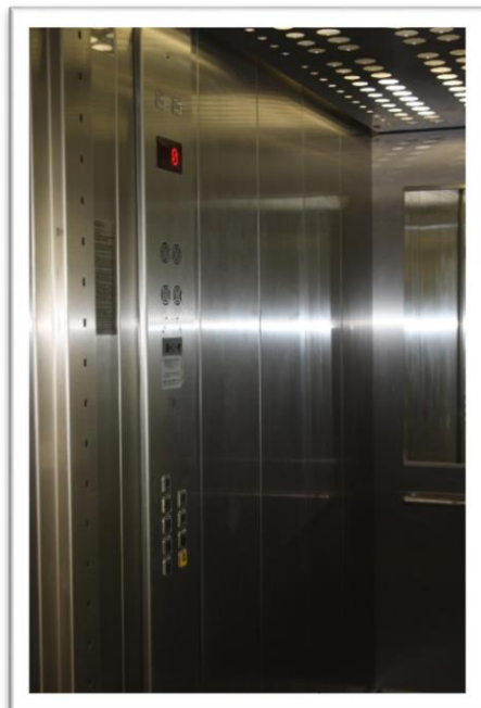
Windy w budynku
