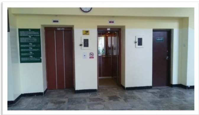
Windy w budynku z drzwiami rozsuwanymi
