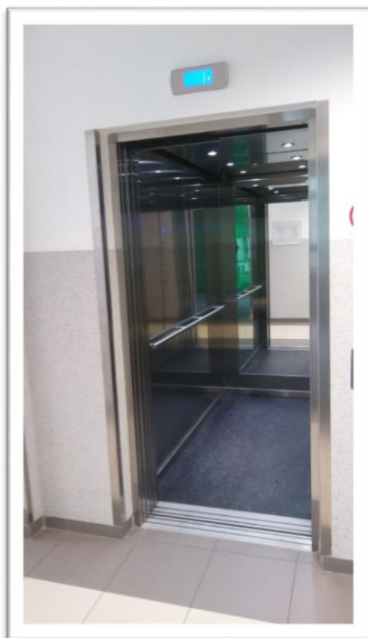
Winda wewnątrz budynku
