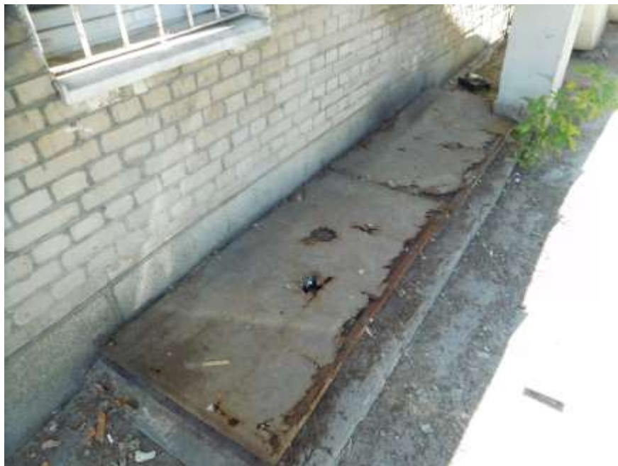
Fot. 18: Korozja przekrycia włązów piwnicznych od strony północnej budynku
