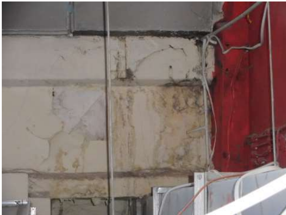
Fot. 14: Zaciek w strefie podporowej dźwigara dachowego (oś C/7 – od strony sali 1)
