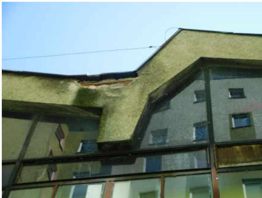
Fot. 27: Uszkodzenie wyprawy elewacyjnej od strony północnej pod obróbką blacharską
