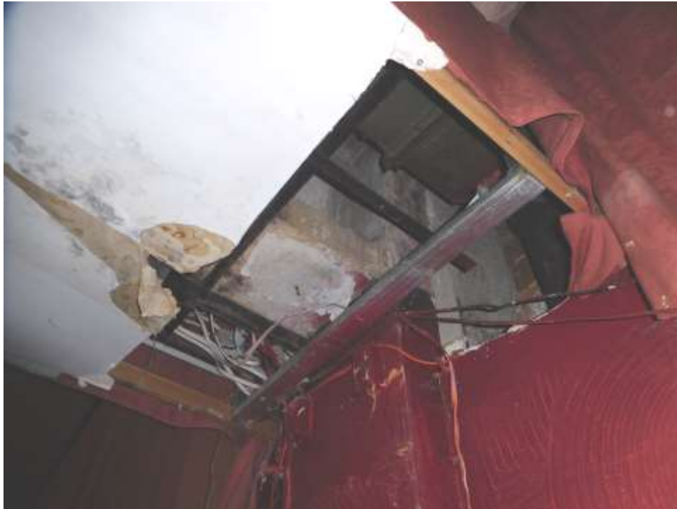
Fot. 13: Zaciek w strefie podporowej dźwigara dachowego (oś C/7 – sala 5)
