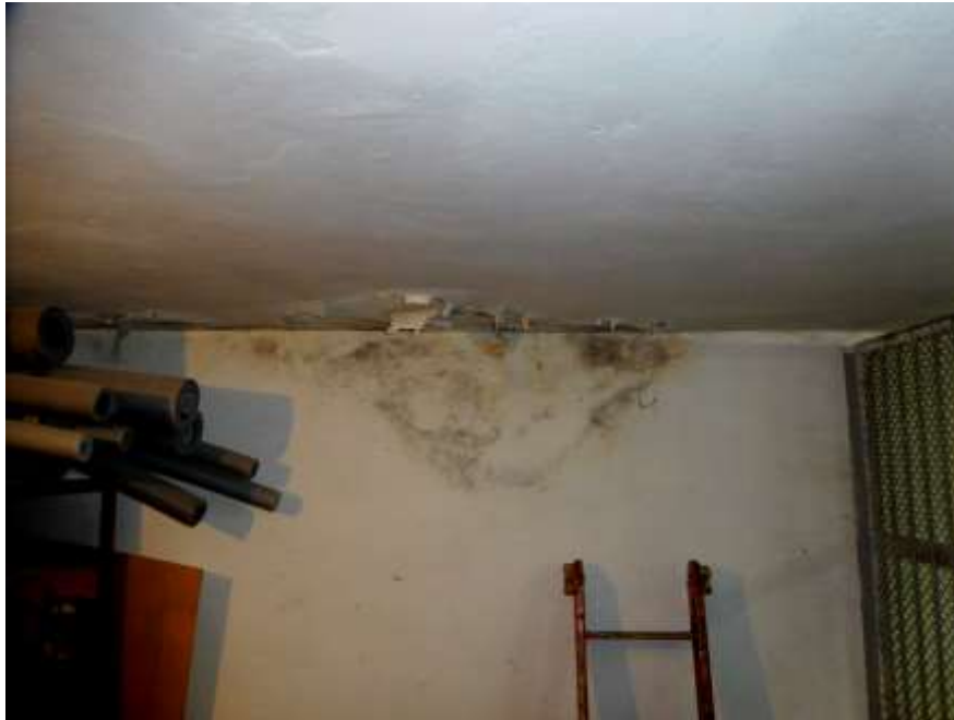
Fot. 7: Zawilgocenie fragmentu ściany w piwnicy (pomieszczenie magazynowe nr 8)
