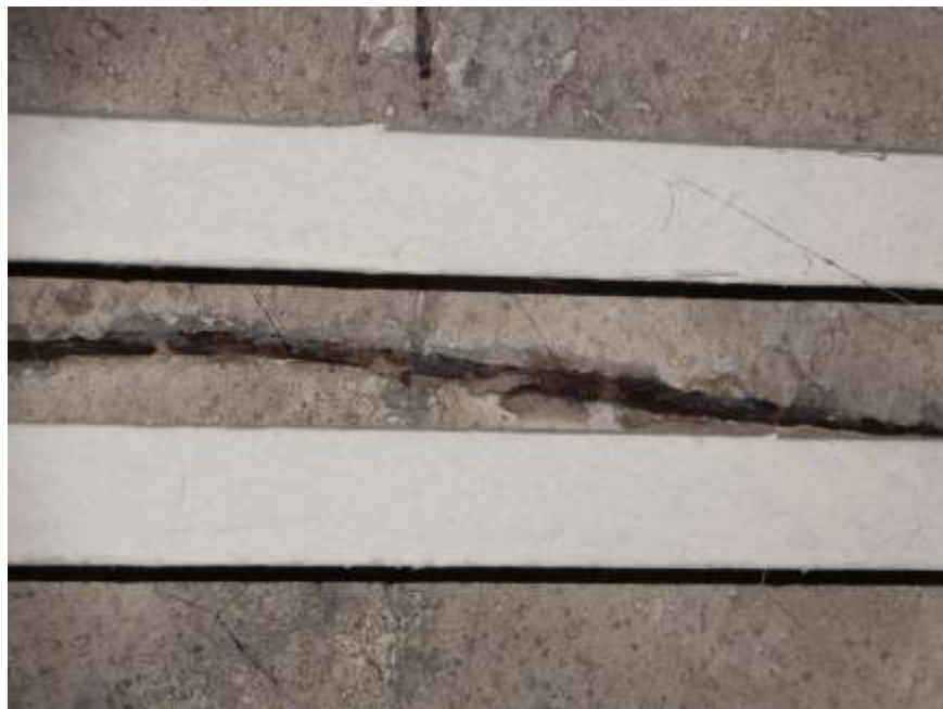
Fot. 10: Uszkodzenie otuliny i korozja zbrojenia płyty dachowej (sala nr 1)
