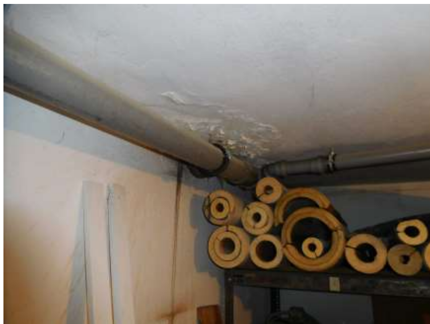
Fot. 8: Zawilgocenie fragmentu sufitu w piwnicy (pomieszczenie magazynowe nr 8)
