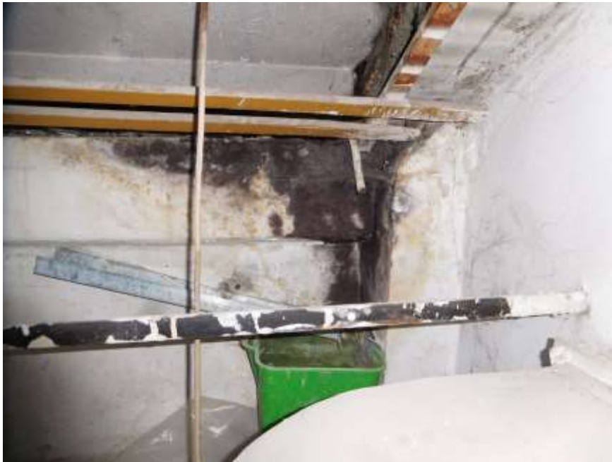
Fot. 17: Korozja biologiczna w rejonie zacieku w strefie podporowej dźwigara dachowego (oś E/4)
