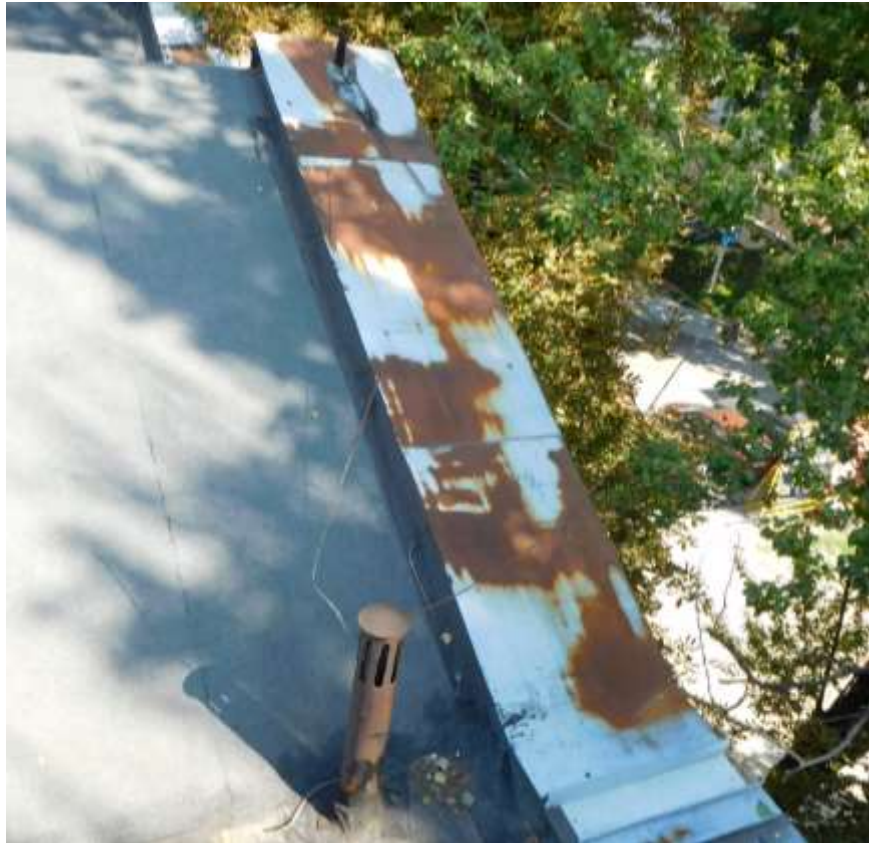
Fot. 25: Korozja obróbek blacharskich
