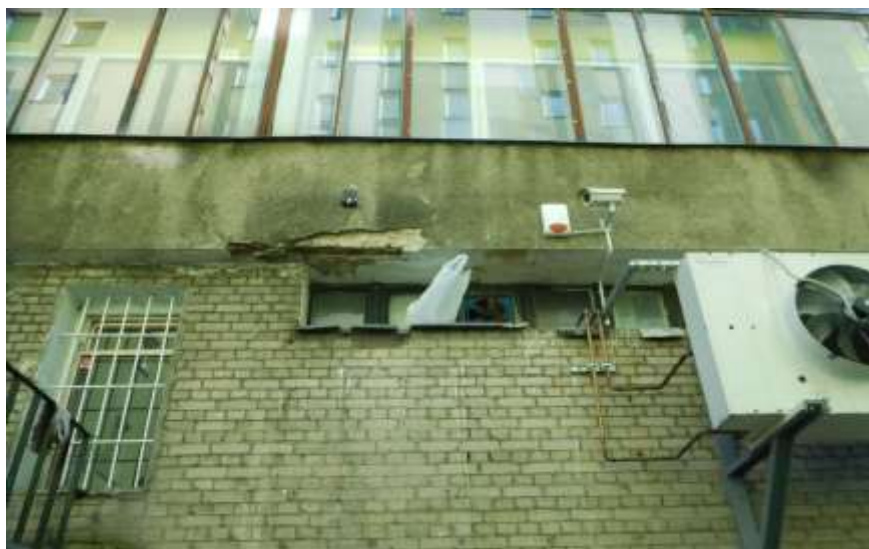
Fot. 26: Uszkodzenie wyprawy elewacyjnej od strony północnej, ubytki podokienników
