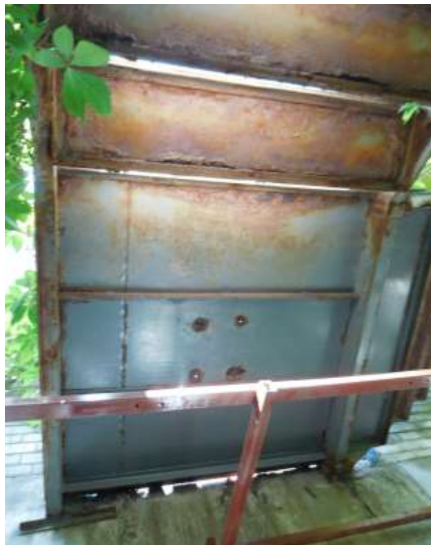
Fot. 22: Korozja spocznika schodów stalowych od strony zachodniej
