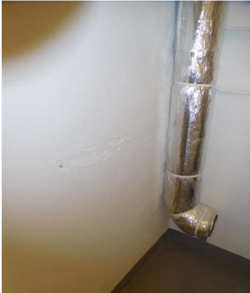
Fot. 6: Lokalne uszkodzenie tynku na skutek zawilgocenia ścian piwnic (pomieszczenie techniczne przy archiwum)
