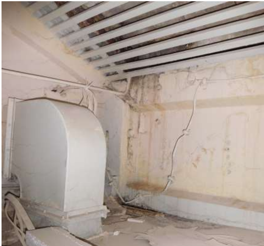
Fot. 12: Zaciek w strefie podporowej dźwigara dachowego (oś C/6)
