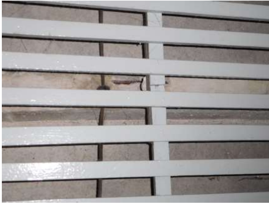
Fot. 11: Uszkodzenie otuliny i korozja zbrojenia płyty dachowej (sala nr 1)
