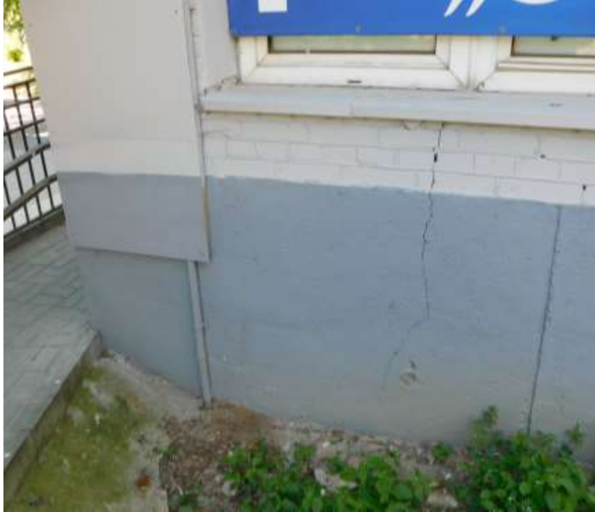
Fot. 19: Pęknięcie elewacji w narożniku południowo-zachodnim
