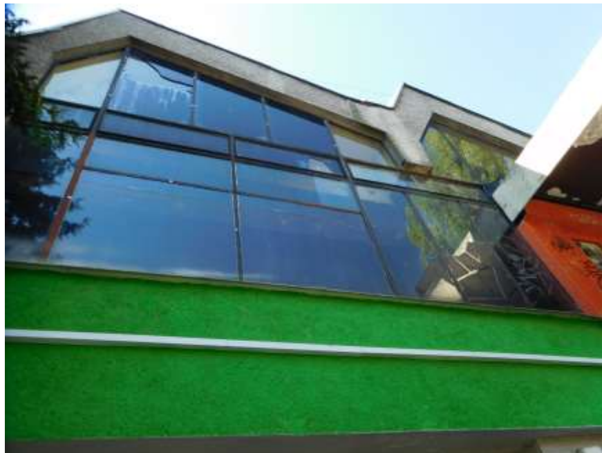
Fot. 20: Uszkodzenie szklenia elewacji południowej
