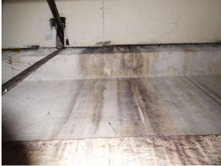
Fot. 15: Zaciek w strefie przęsłowej dźwigara dachowego (oś F-E/7 – sala 2)
