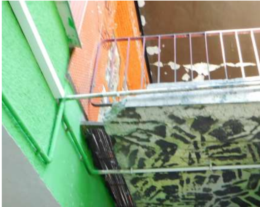
Fot. 21: Uszkodzenie narożnika płyty żelbetowej – schody wejściowe
