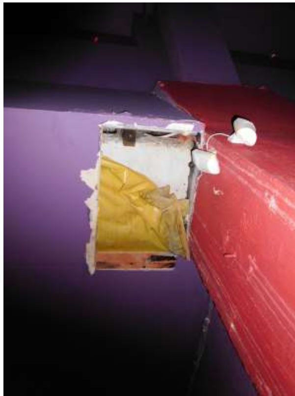
Fot. 16: Zaciek w strefie podporowej dźwigara dachowego (oś E/2)
