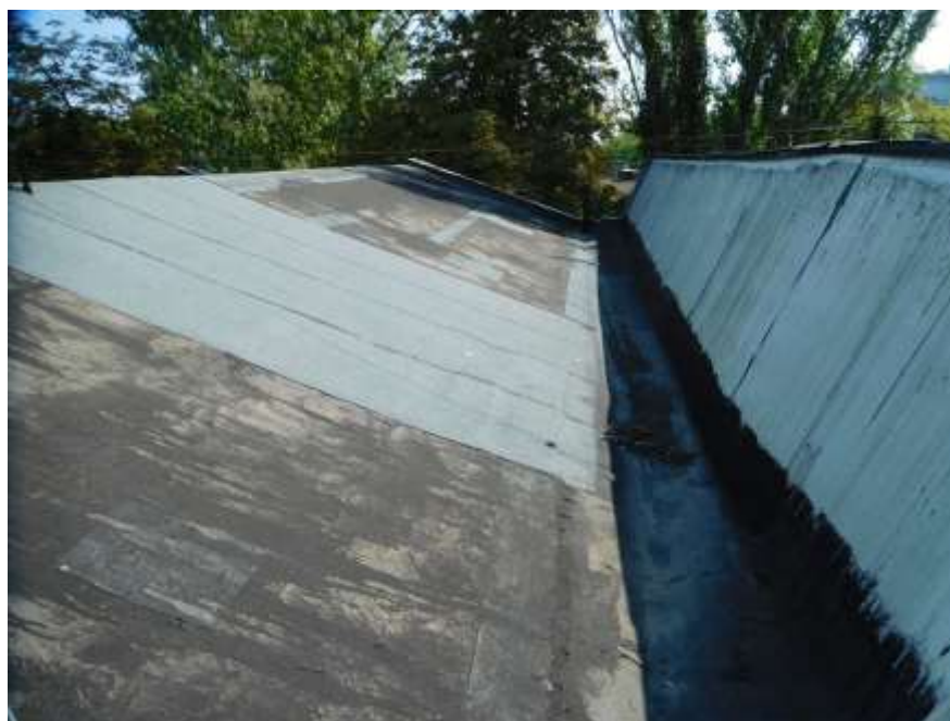
Fot. 24: Zużycie pokrycia papowego dachu
