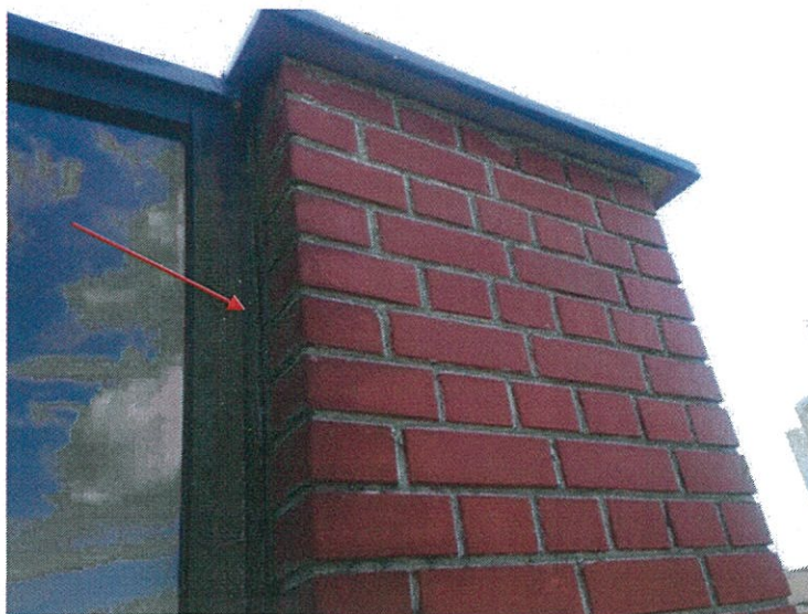
Fot.3. Widok szczeliny pomiędzy ścianą i witryną szklaną od strony ul. J. Sowińskiego.
