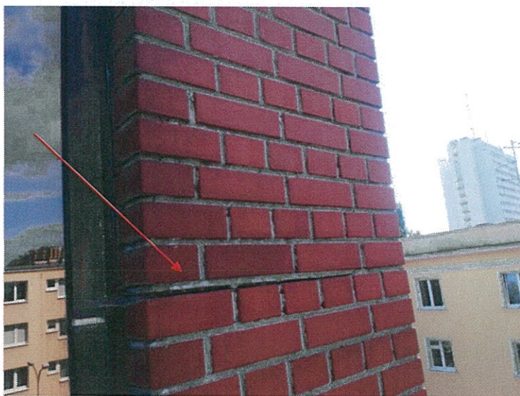
Fot.4. Widok rysy w poziomie stropu ostatniej kondygnacji od strony ul. J. Sowińskiego.
