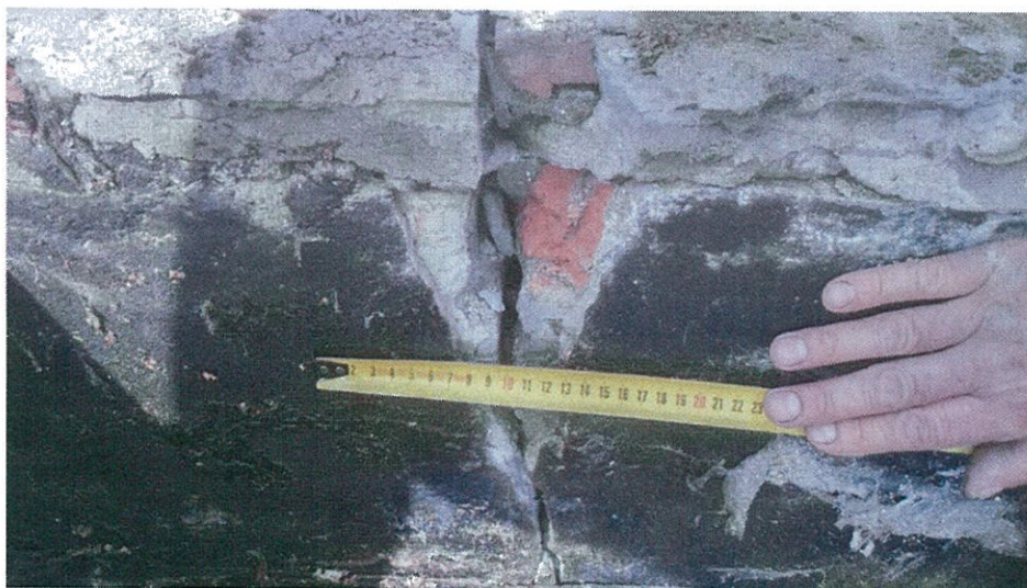
Fot.6. Widok uszkodzenia murku attyki od strony dachu.
