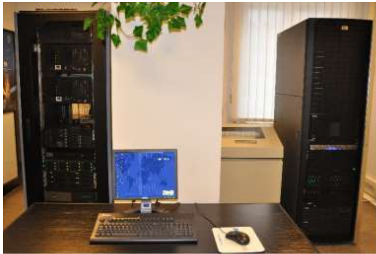
Serwery umieszczone w szafach, realizują domenę Active Directory STAT dzięki której zintegrowane są zasoby sieciowe US i GUS 2012 r.
