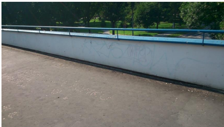
Fot 63. Kładka nr 1, bariera
