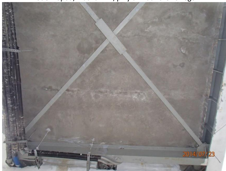
Fot 88. Spód, Kładka nr 2, przy ul. Radziszewskiego.
