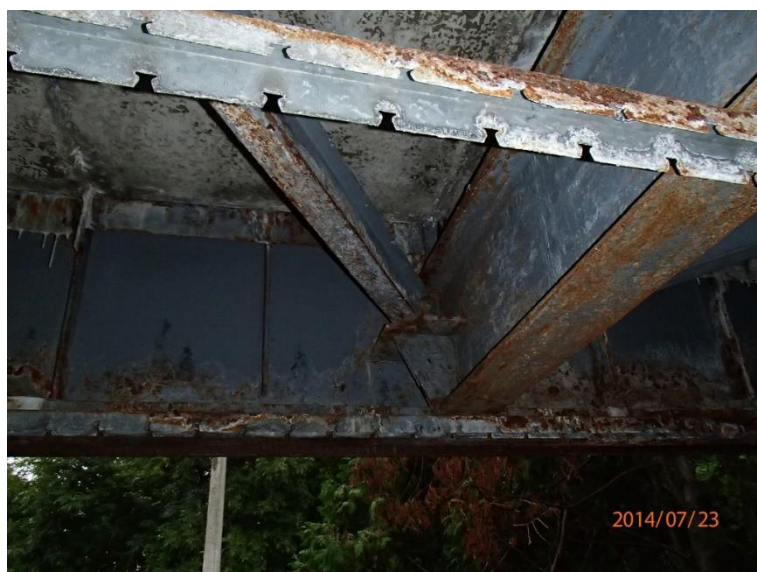
Fot 29. Kładka nr 1, widok od spodu przy ulicy Sowińskiego.
