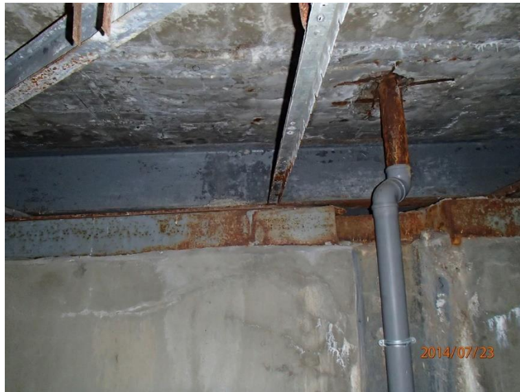
Fot 33. Kładka nr 1, widok od spodu przy ulicy Sowińskiego.
