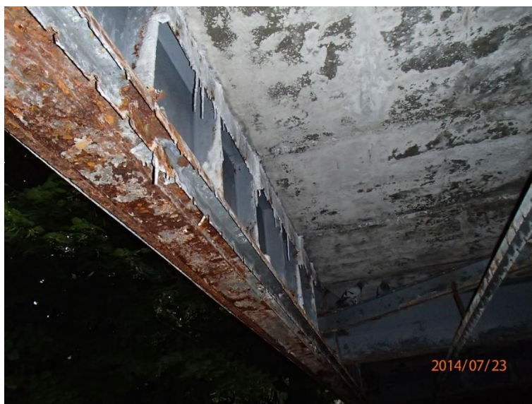
Fot 32. Kładka nr 1, widok od spodu przy ulicy Sowińskiego.
