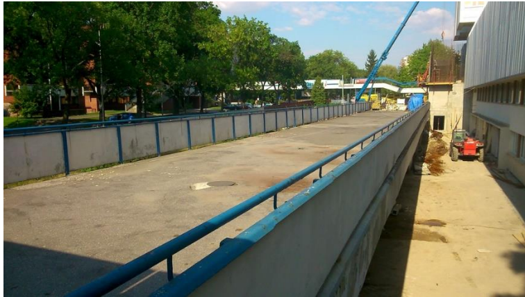
Fot 61. Kładka nr 1, bariera
