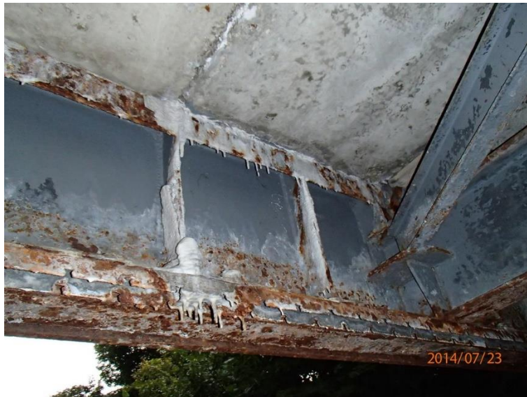
Fot 30. Kładka nr 1, widok od spodu przy ulicy Sowińskiego.
