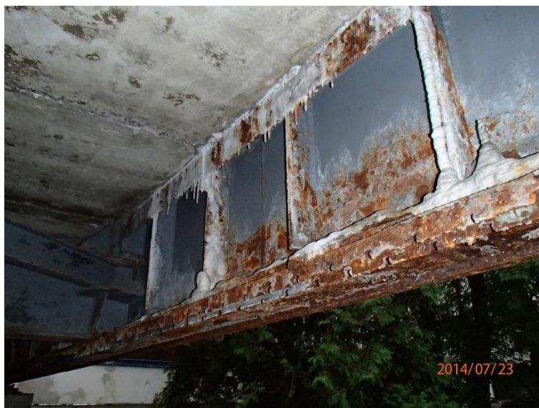
Fot 31. Kładka nr 1, widok od spodu przy ulicy Sowińskiego.
