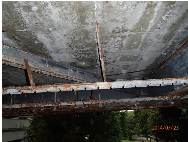
Fot 27. Kładka nr 1, widok od spodu przy ulicy Sowińskiego.
