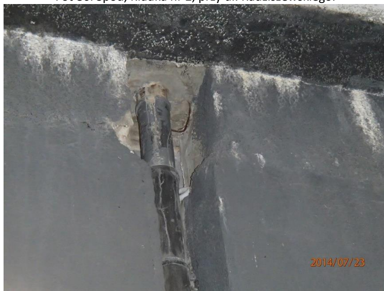
Fot 87. Spód, Kładka nr 2, przy ul. Radziszewskiego.
