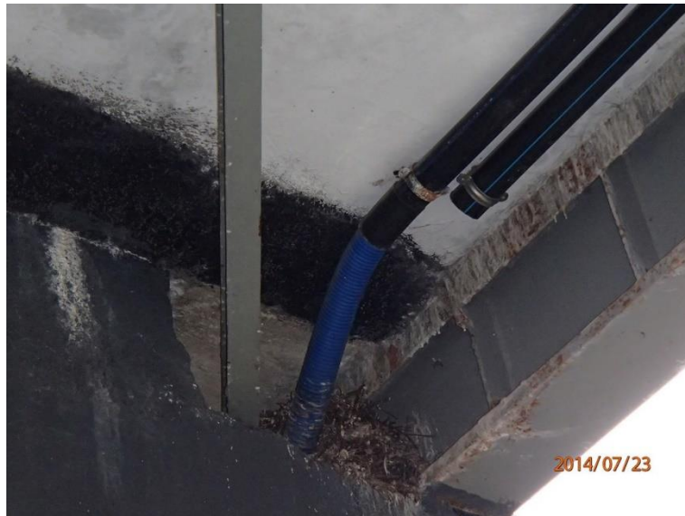
Fot 86. Spód, Kładka nr 2, przy ul. Radziszewskiego.
