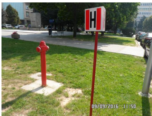
HYDRANT NADZIEMNY plac wewnętrzny [ok. 15 m od budynku]
